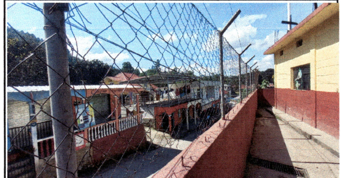
Foto 10: Muro perimetral. Malla en mal estado, necesita sustitución.
