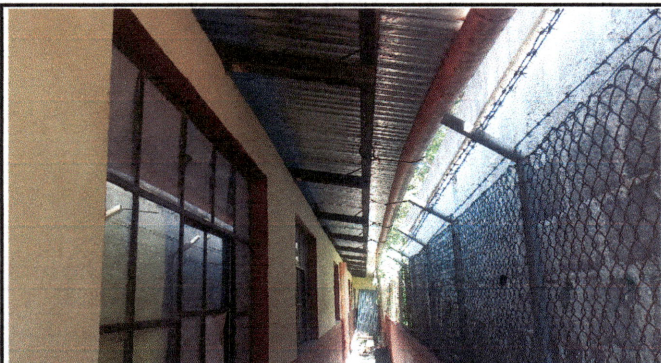
Foto 1: En módulo 1, se observa canal de tubería pvc, necesita sustitución por Canal de Lámina Lisa y Pescantes de Metal
