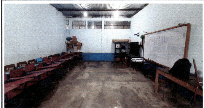
Foto 9: Aula 2 del módulo 4, piso en mal estado que necesita ser reemplazado.
