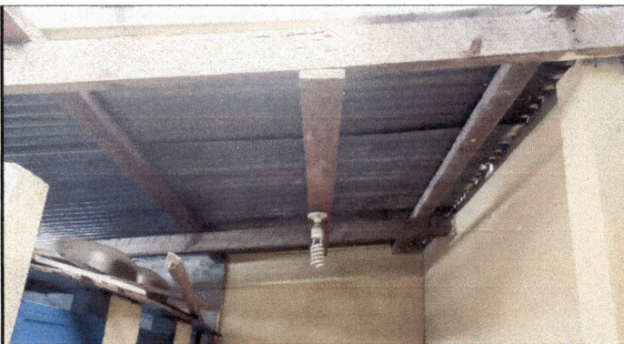
Foto 3: Módulo Baños, Estructura de techo de madera necesita sustitución por estructura metálica.
