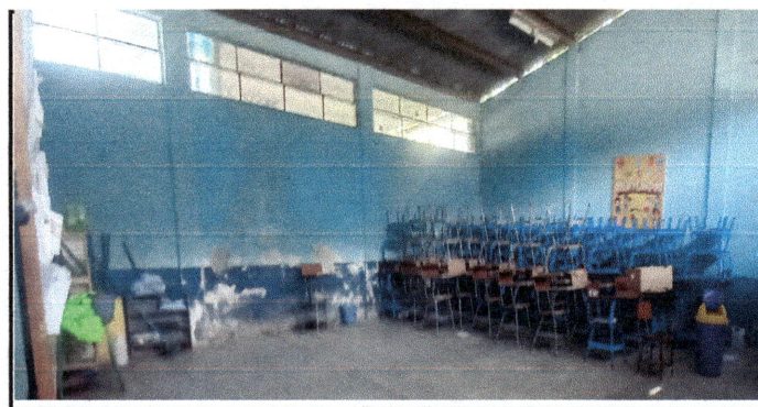
Foto 6: aulas del módulo 3 con pintura en paredes en mal estado.
