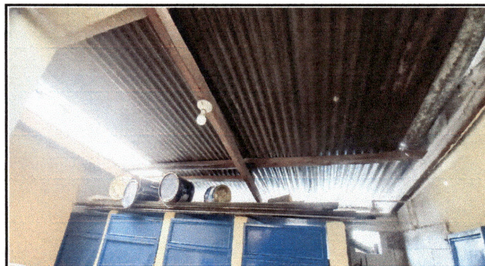
Foto 4: Módulo Baños, Cubierta de lámina en mal estado, que necesita sustitución de lamina por lámina troquelada
