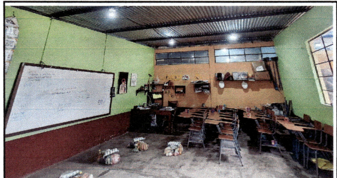
Foto 8: Aula 1 del módulo 4, piso en mal estado que necesita ser reemplazado.
