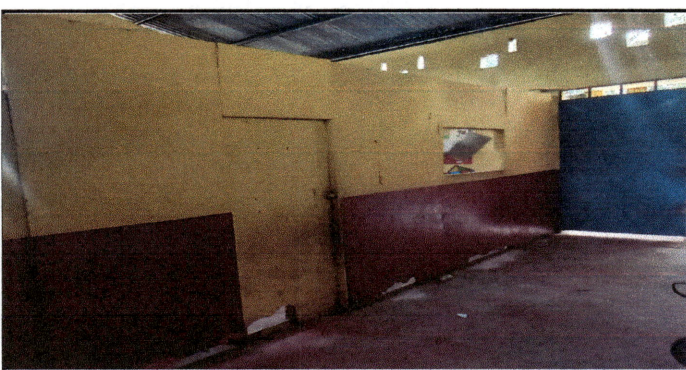
Foto 5: Aula 3 del módulo 3, con una pared en mal estado que es necesaria rehabilitarla
